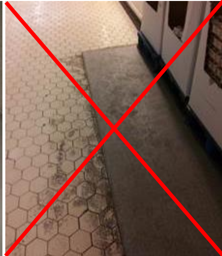
nicht geeigneter Bodenbelag
